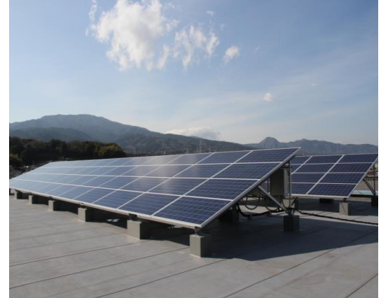
富水小屋上に設置されたソーラーパネル
